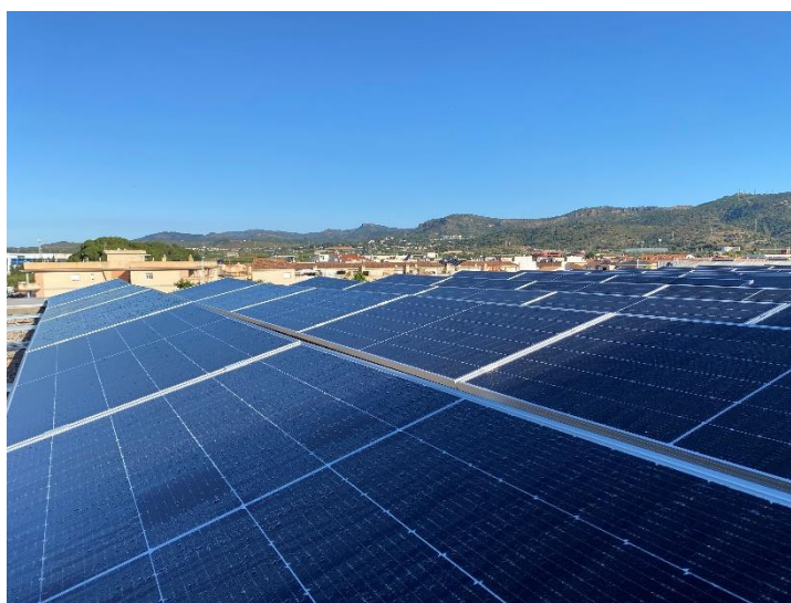
Imagen de las placas solares instaladas en la sede central de SanLucar en Puzol (Valencia)
